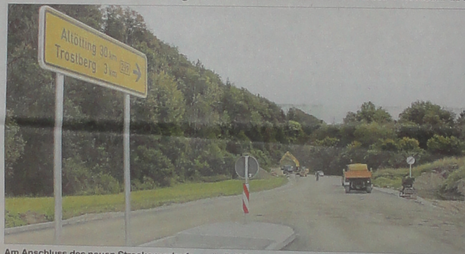
Am Anschluss des neuen Streckenverlaufs an die B 299 nach Trostberg wird intensiv gearbeitet.
