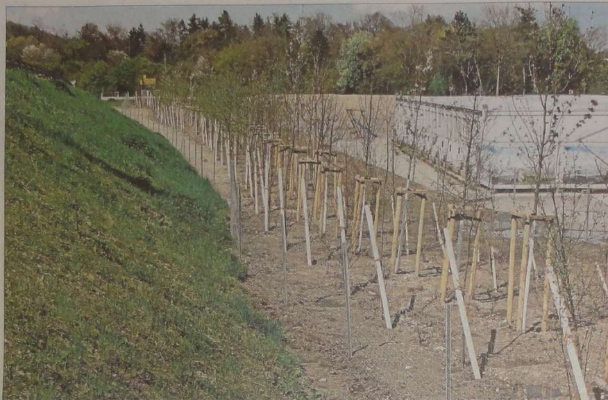
Zwischen Aubertunnelportal und Wohncontainern soll eine rund 150 Meter lange Baum- und Heckenreihe dafür sorgen, dass Fledermäuse auf ihren Flugrouten nicht in den fließenden Verkehr geraten. – Foto: UVA
