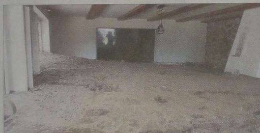
Das Wohnzimmer war nach dem Murenabgang komplett zerstört. Ein Minibagger musste den Schlamm herausschaufeln.
